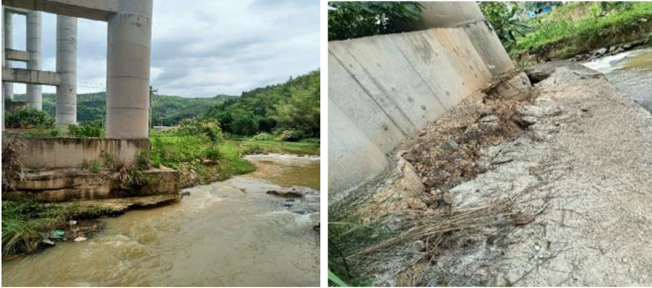
中洋互通洋后至建瓯匝道损毁图
